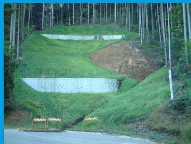
まさ土のり面
